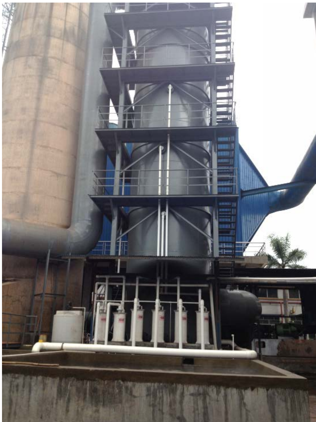
废气脱硫塔：运行正常
